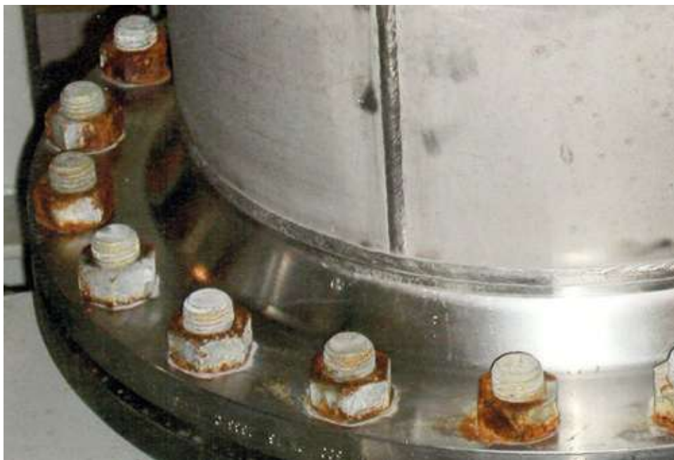
Corrosion galvanique d'écrou galvanisé au contact d'une vanne en acier inoxydable
