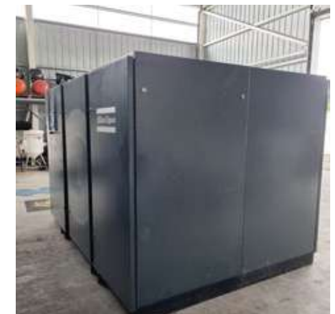
Exemple de compresseur électrique Atelier
